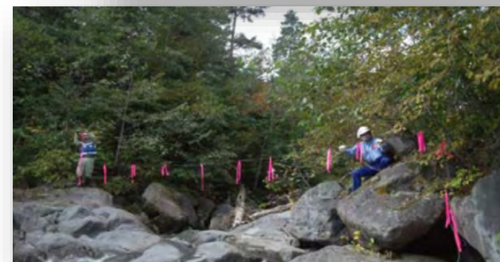
ワイヤーセンサー設置の状況
