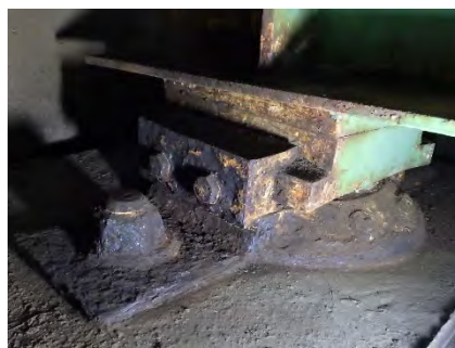
損傷部位の確認
