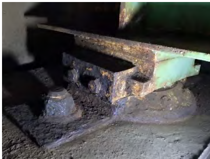
損傷部位の確認
