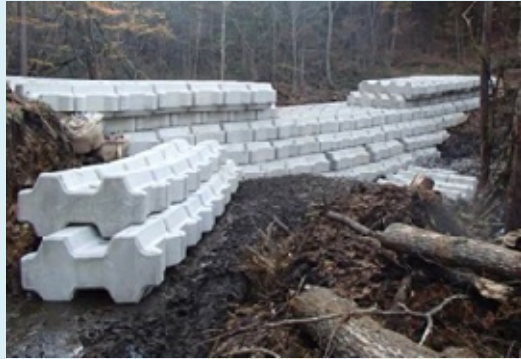
コンクリートブロック積み砂防堰堤 (鹿ノ瀬川、国土交通省中部地方整備局)
