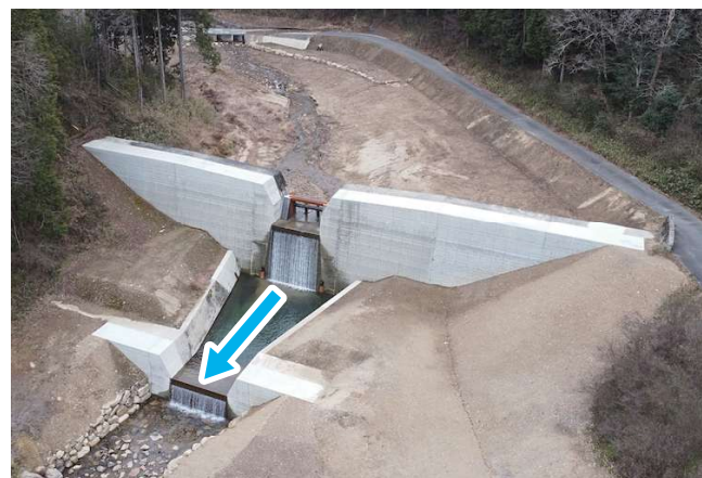
か じ が いり さ ぼう えん てい (と き 鍛冶ヶ入第 4 砂防堰堤 (改築) (土岐市)
