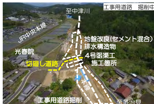
工事用道路の掘削、本線及び4号横断函渠工の地盤改良工を施工しています。
