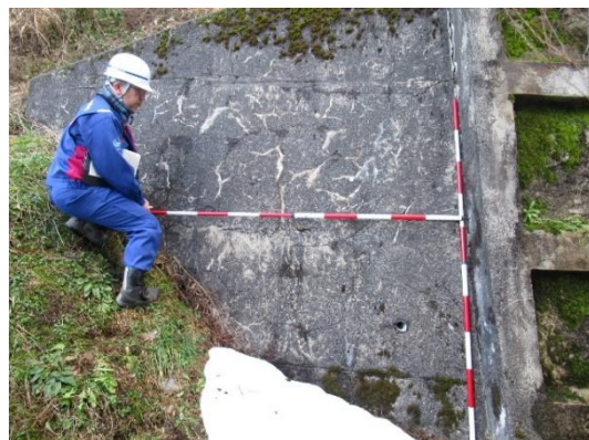
急傾斜地の被災状況調査
