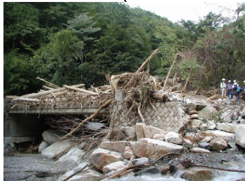
平成12年9月の恵南豪雨時の流木による被災状況(中津川支川一ノ沢)
