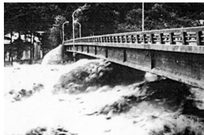
南木曽橋の主桁にせまる濁流 〈出典：「中部の水害」〉
