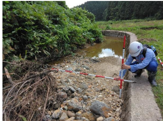
急傾斜地の被災状況調査
