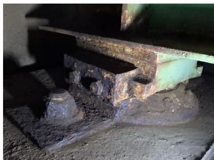
損傷部位の確認
