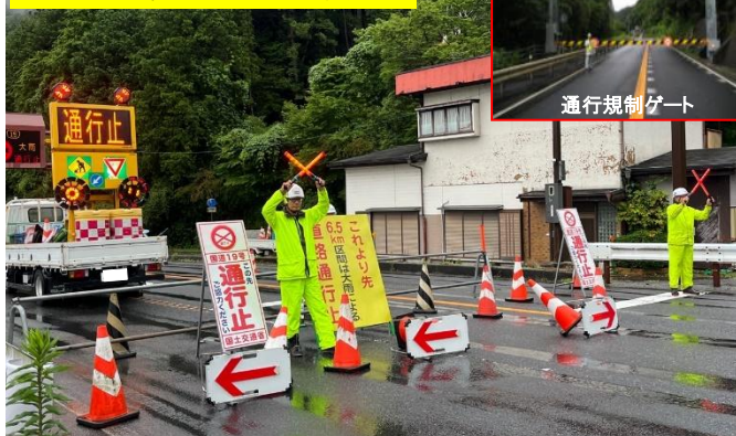
大雨による現地通行止めの実施
