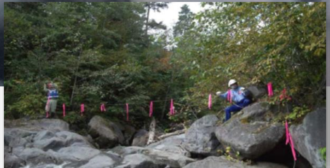
ワイヤーセンサーの設置状況
