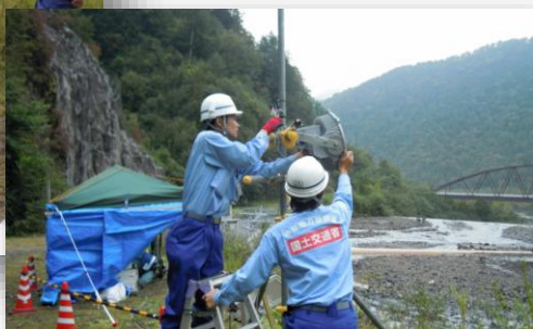
監視カメラの設置状況
