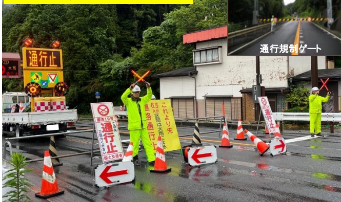
大雨による現地通行止めの実施
