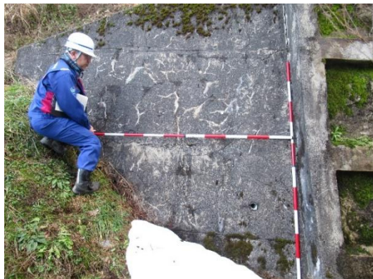
急傾斜地の被災状況調査
