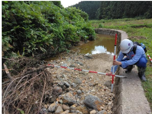
急傾斜地の被災状況調査
