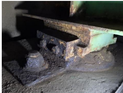
損傷部位の確認
