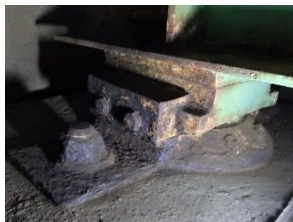
損傷部位の確認
