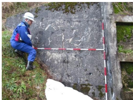
急傾斜地の被災状況調査
