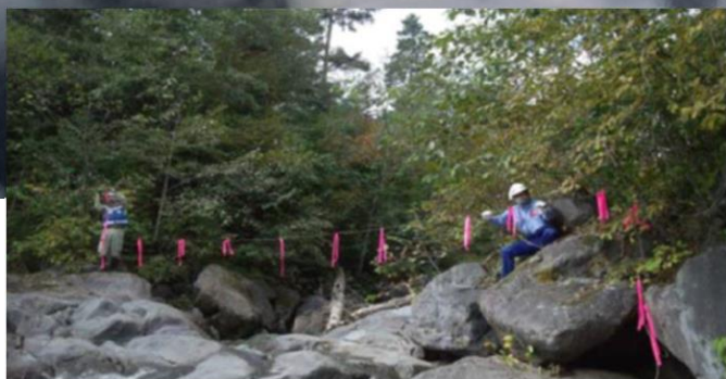
ワイヤーセンサーの設置状況
