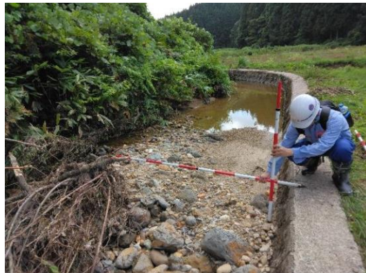
急傾斜地の被災状況調査
