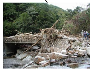
平成12年9月の恵南豪雨時の 流木による被災状況（中津川支川一ノ宮）
