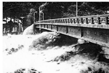
南木曾橋の主桁にせまる濁流（出典：「中部の水害」）
