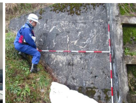
急傾斜地の被災状況調査
