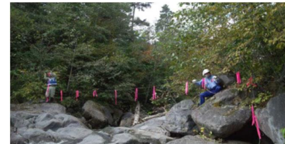
ワイヤーセンサー設置の状況
