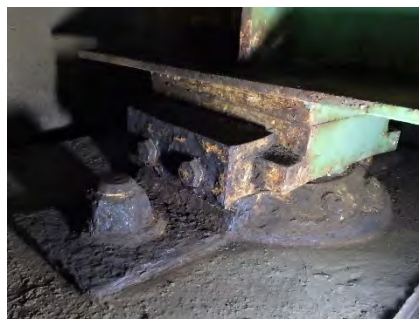
損傷部位の確認
