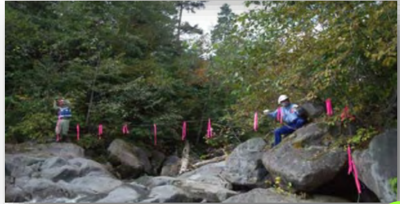
ワイヤーセンサー設置の状況
