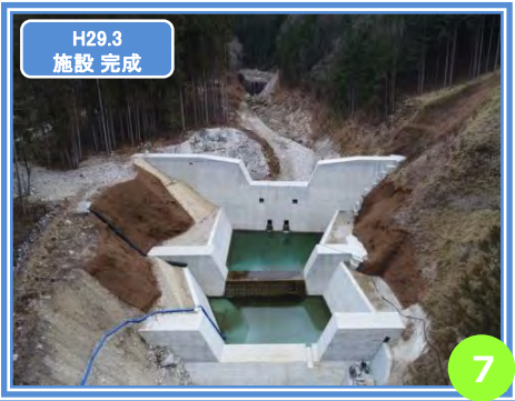
＜ 梨子沢第4砂防堰堤 ＞
