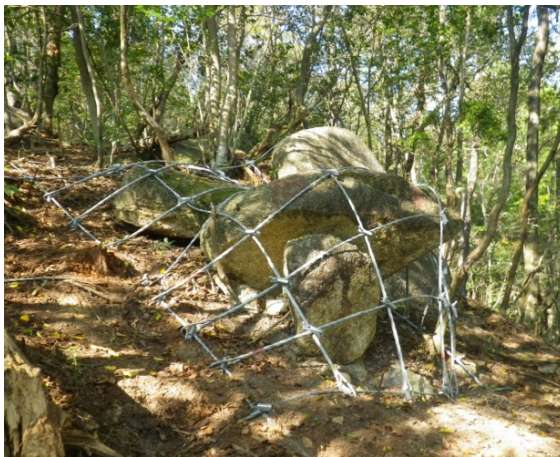
落石対策(ロープネット)
