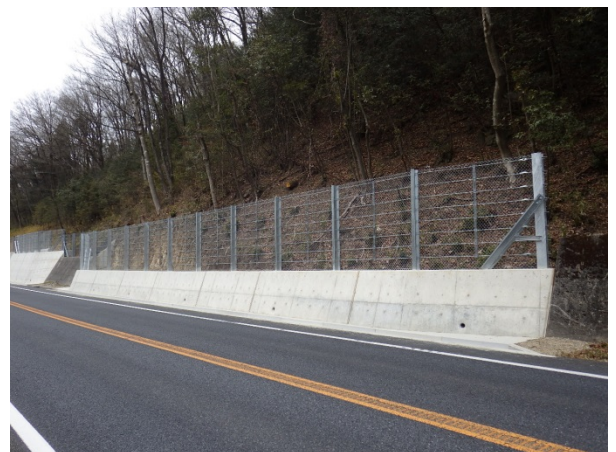
落石対策(防護柵)
