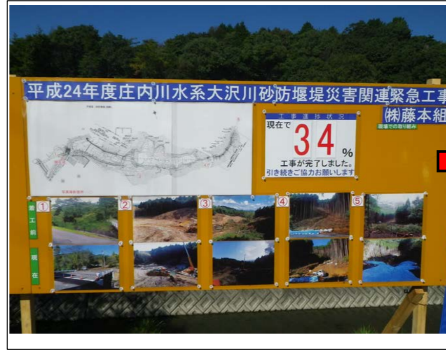
「見える化」看板設置状況写真
