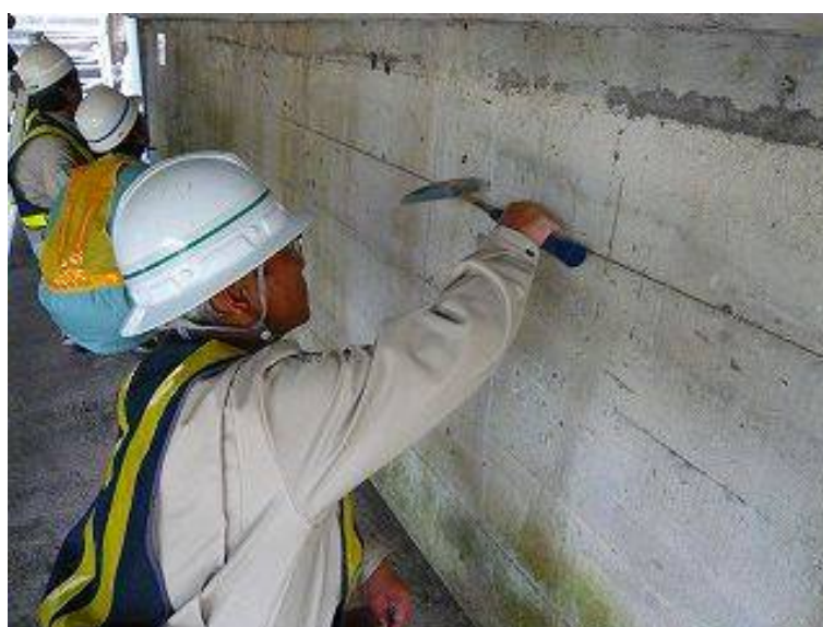
橋台のクラック箇所の叩き点検
