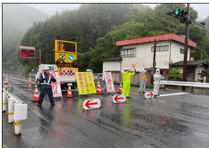
R6.6.28 通行止めの様子 (弥栄橋交差点)
