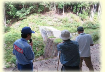
高強度ネットにより補強された石積み穴ヶ沢第1砂防堰堤
