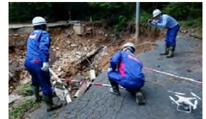
宮古市川代地区でドローンによる被災状況調査を実施
