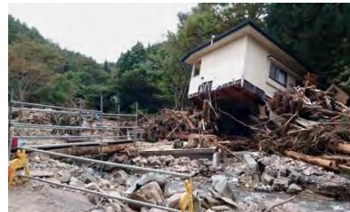
岩手県宮古市白浜地区の土石流による被災現場にて調査
