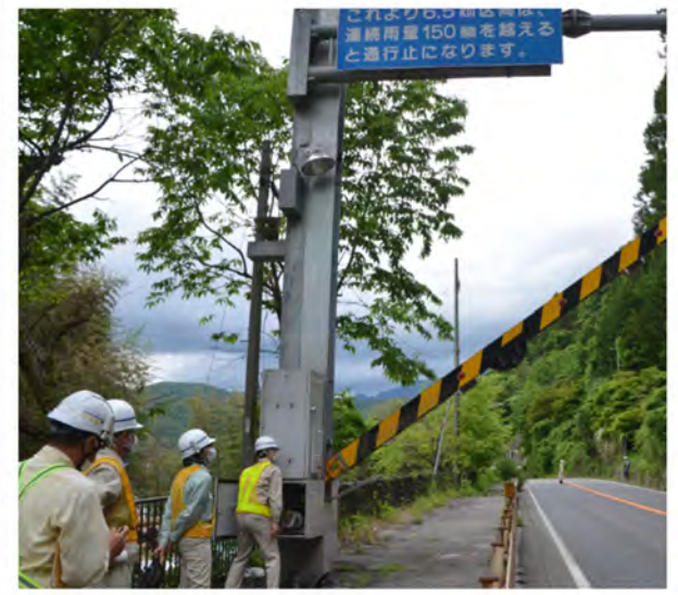
停電に備え、手動ハンドルの操作も実施
