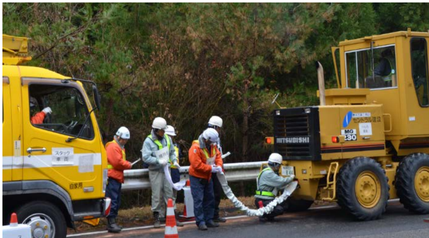
立ち往生車両(左側のトラックで、スタック車両)の牽引準備中
