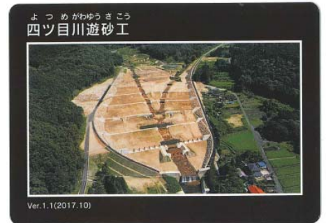
よつめがわゆうさこう 四ツ目川遊砂工 (岐阜県中津川市松田)
