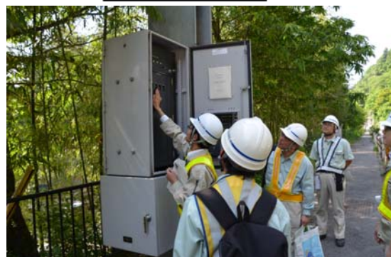
遮断機操作の様子
