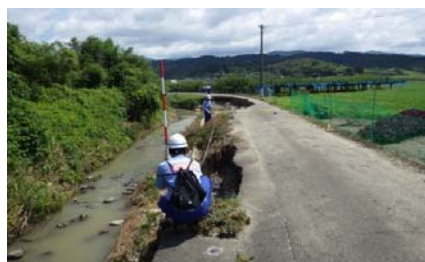
【被災状況調査(九州北部豪雨)】
