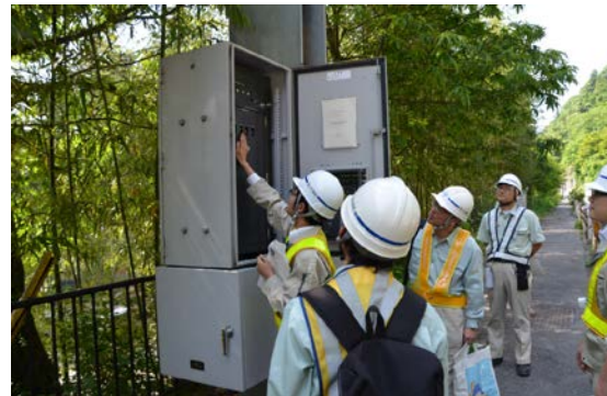
遮断機操作の様子
