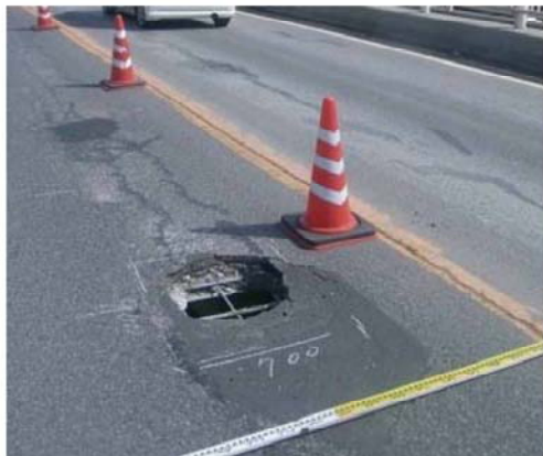
コンクリートの床版が抜け落ち、舗装に空いた穴
