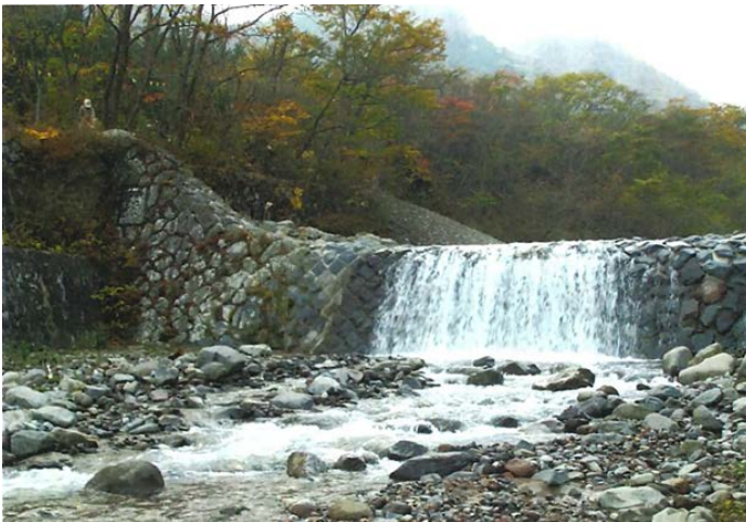
丸味を帯びた水通しを有する砂防えん堤 (稲荷川第2砂防ダム)
