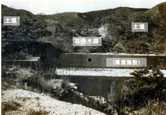
土えん堤(石張水路付) (釜下第2砂防ダム;昭和15年9月30日竣工) ※手前の施設は県営のコンクリートえん堤である。
