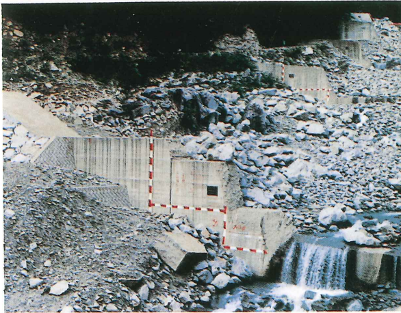
土石流により破壊された谷止工袖部
