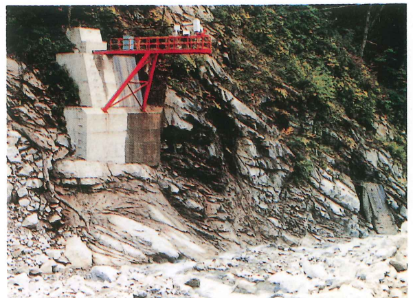
カメラ類取付状況
