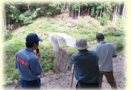
高強度ネットにより補強された石積み穴ヶ沢第1砂防堰堤
