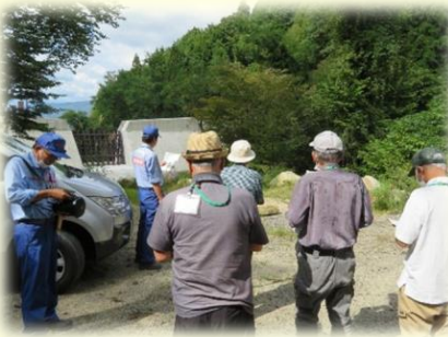
不透過型から部分透過型に改修された下平次第8砂防堰堤
