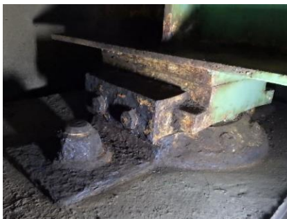
損傷部位の確認
