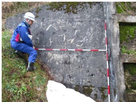
急傾斜地の被災状況調査
