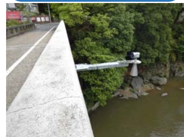
鹿乗橋の危機管理型水位計
