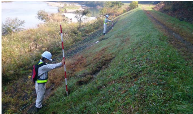
堤防の法崩れ（庄内川 30.4k付近）
