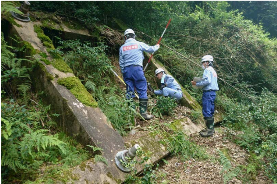
急傾斜地 被害状況調査（7/19）
