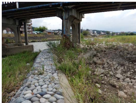
低水護岸裏の洗堀（土岐川 58.0k付近）
