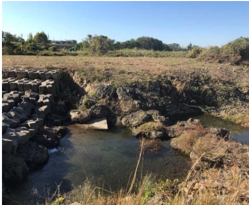
河道の洗掘 （庄内川 25.7k付近）
