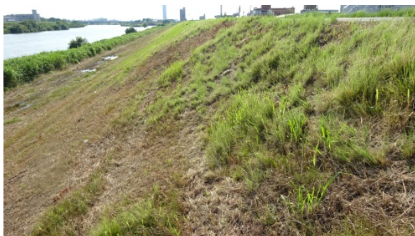
堤防法面の不陸 (庄内川 22.6k付近)
