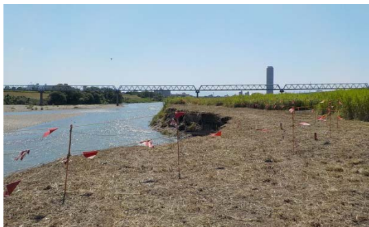
高水敷の洗堀 (庄内川 21.8k付近)
