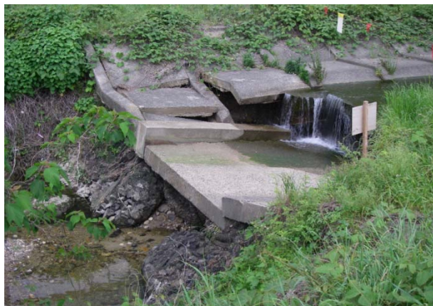
床固が損傷 (庄内川 25.7k 白沢川合流点付近)
