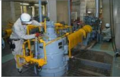
ポンプ設備の点検
