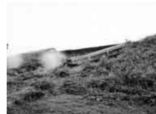
東海豪雨で崩壊した法面状況
