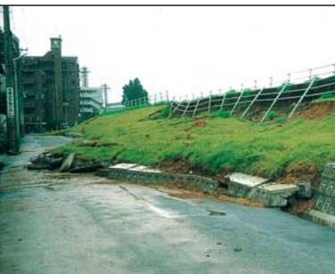
●堤防崩壊状況
