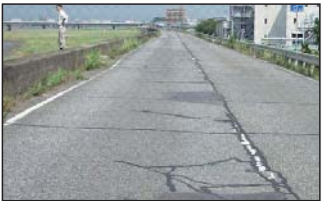
●高潮堤防の天端ひび割れ状況
