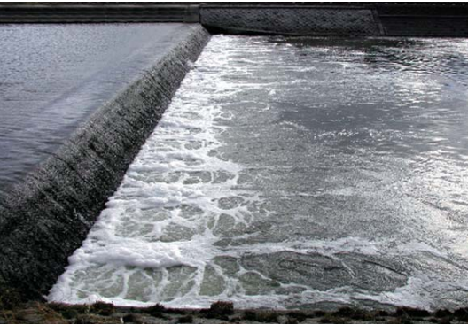
●写真2.1.25 米ヶ瀬の床止め （生活排水の影響により発泡現象が目立つ）
