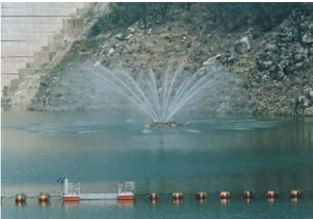
●小里川表層循環設備
