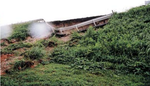
●写真2.1.6 堤防の不安定化、損傷
