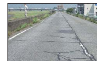
●高潮堤防の天端ひび割れ状況
