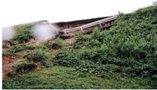
●写真2.1.6 堤防の不安定化、損傷
