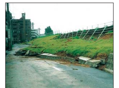
●堤防崩壊状況
