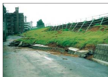
●写真2.1.4 八田川の法崩れの被災状況 (春日井市)
