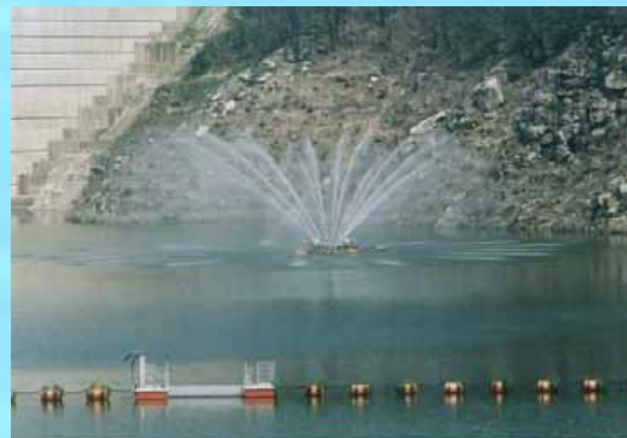
小里川表層循環設備
