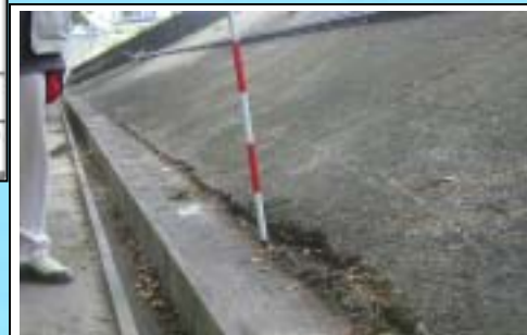
堤防川裏法尻破損 (宝神)
