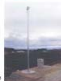
河川監視用カメラ
