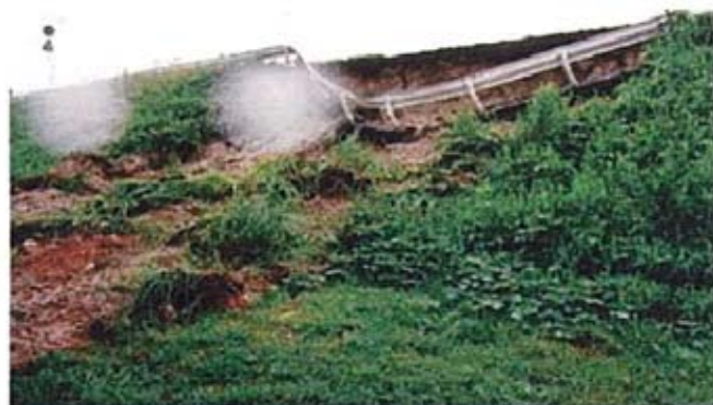
●東海豪雨で崩壊した法面状況(矢田川 2.0K付近)
