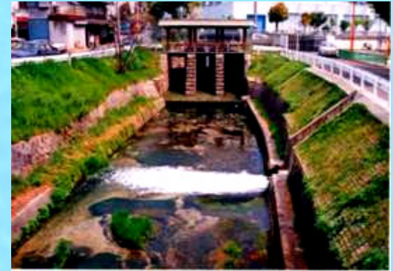
地下鉄工事に伴い湧出する地下水(黒川樋門)
