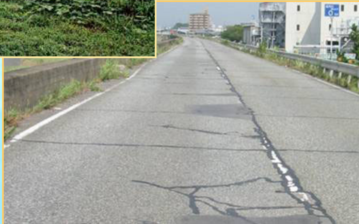
クラックの入った状況 (0.8K付近)
