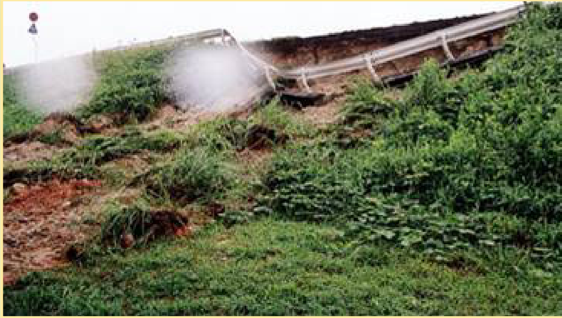
東海豪雨で崩壊した 法面状況 (矢田川2K付近)
