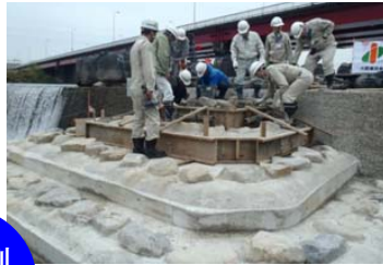
河川管理者と協働による魚道工事(矢田・庄内川をきれいにする会)
