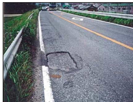
ポットホール(庄内川左岸13.6k付近)
