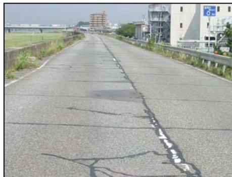
クラック(庄内川左岸0.8k付近)
