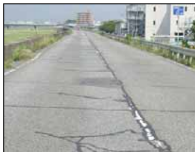
クラック (庄内川左岸0.8k付近)
