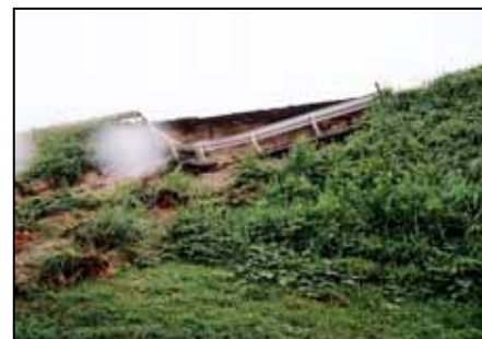
川裏側法面崩壊(東海豪雨時) (矢田川左岸2.0k付近)
