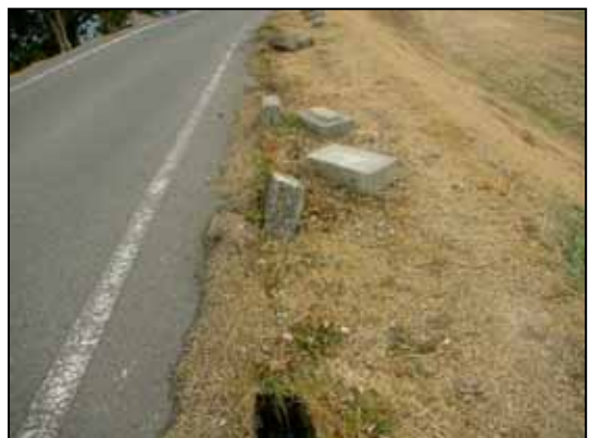
路肩のブロック等の損傷 (矢田川右岸4.6k付近)
