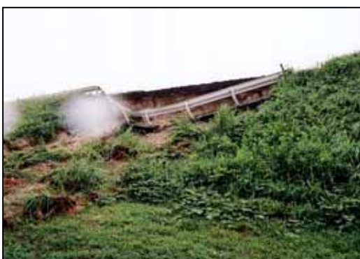
川裏側法面崩壊(矢田川左岸2.0k付近)
