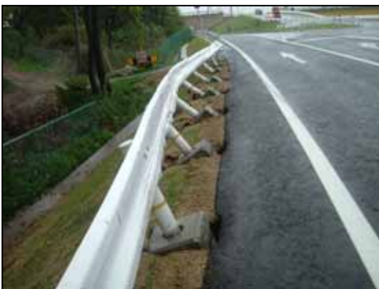
ガードレール等の損傷 (庄内川左岸7.2k付近)
