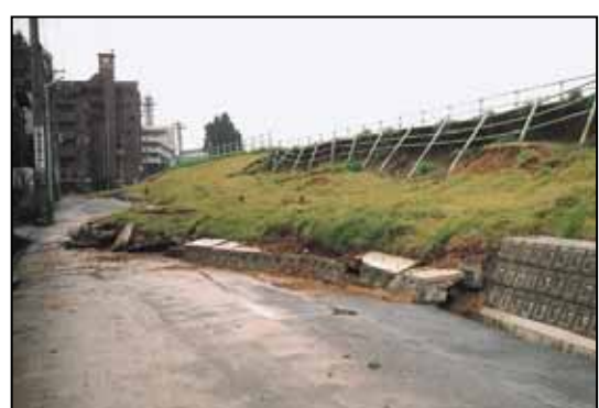
川裏側法面崩壊(八田川左岸0.8k付近)
