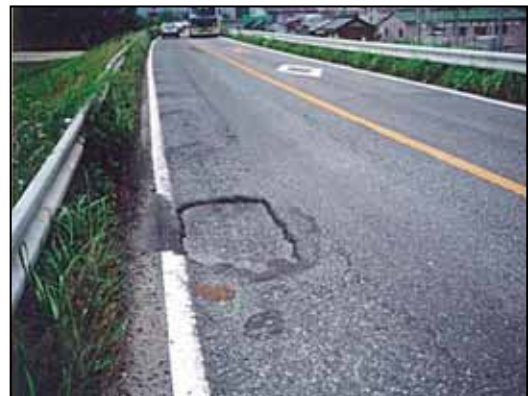
ポットホール(庄内川左岸13.6k付近)
