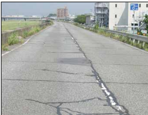
クラック(庄内川左岸0.8k付近)
