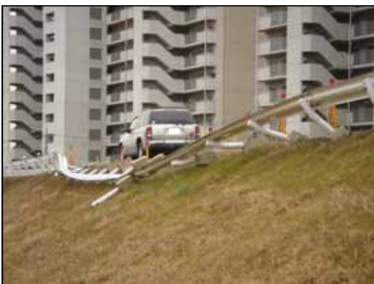
ガードレール等の損傷 (矢田川左岸4.2k付近)
