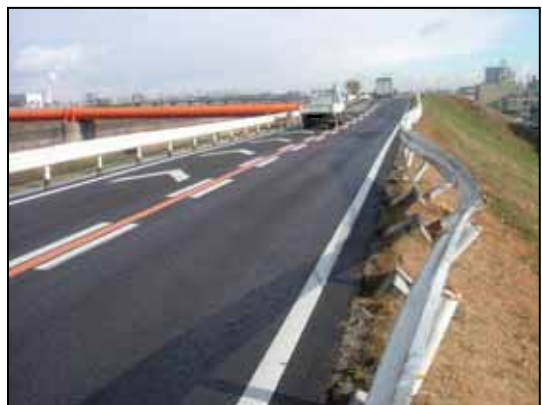
ガードレール等の損傷 (庄内川左岸11.0k付近)
