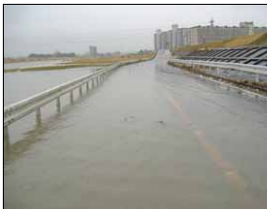
三階橋堤外アンダーパスの水没 (矢田川左岸3.8k付近)
