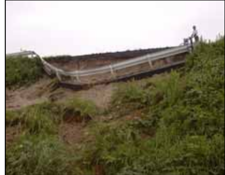
堤防の法崩れ(東海豪雨時)
